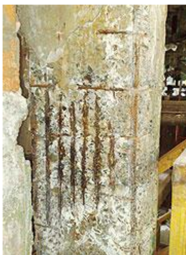
Ataque em indústria têxtil - Pequeno revestimento do concreto expõe armaduras a produtos químicos ácidos usados para branquear tecidos em indústria têxtil. Ocorre exposição dos agregados pela lixiviação da pasta de cimento
