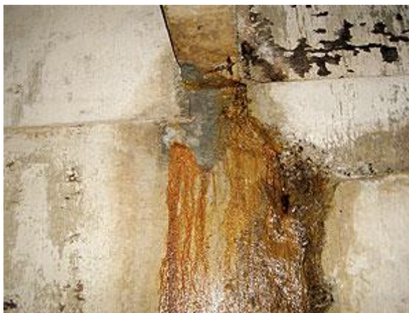
Corrosão de armaduras em subsolo de edifício por infiltração de água
