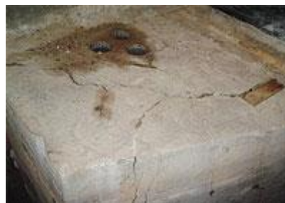
Falha de concretagem - Falha de vibração do concreto acarreta porosidade, que facilita a penetração dos agentes agressivos da atmosfera, como CO 2 , cloretos e sulfatos
