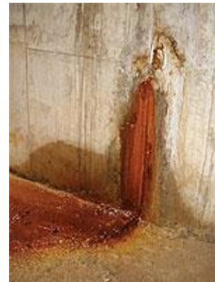
Infiltração de água em subsolo - Infiltração de água que acarreta a perda rápida da alcalinidade do concreto, favorecendo ataque de cloretos e corrosão das armaduras
