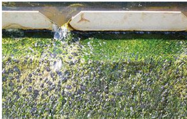
Ataque químico em estação de tratamento de esgoto - Deterioração do concreto em estação de tratamento de esgoto, com exposição dos agregados, onde são comuns os ataques de sulfatos e a erosão pela ação da velocidade da água
